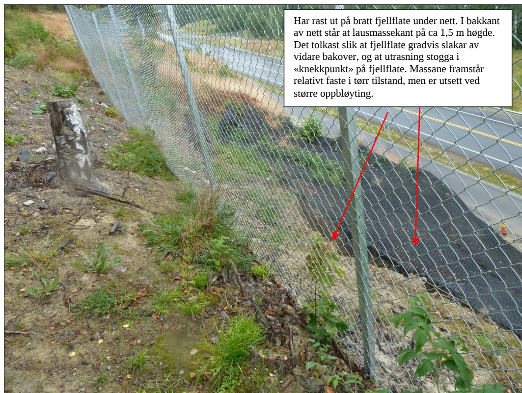
Fig 3: Ca km 3,990. Bruddkant i bakkant av losneområde ca 1,5 m høg.
