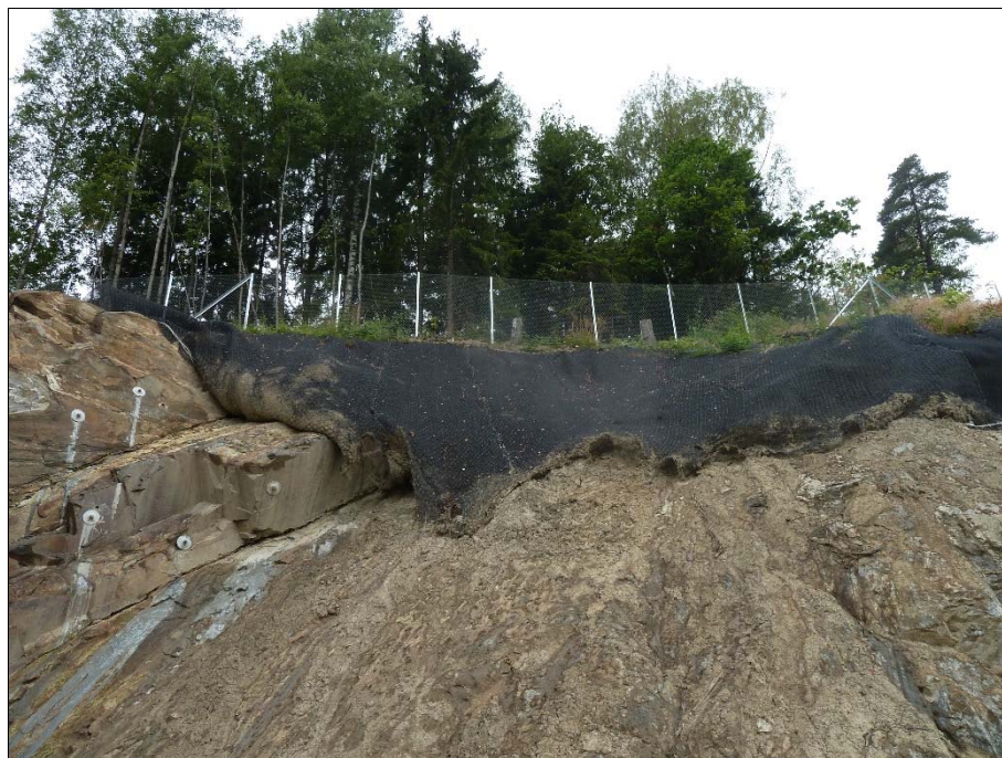
Fig 2: Ca km 3,990. Losneområde er inn under utført nettsikring. Sikringa har gjeve etter i nedkant ved oppbløyting av massane. Tolkast slik at «mage» har oppstått, og at det vidare har rakna langs stigebåndfeste i nedkant av nett. Er ein ca 1,5 m høg lausmassekant bakerst under nettet, sjå og neste figur.
