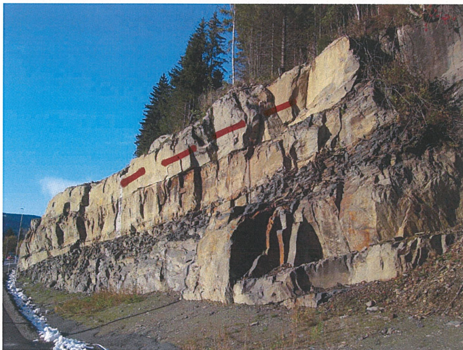
Fjell på topp som heller utover, vurderes boltet med en 3 m lang bolt pr 4 m lengde langs veg. Behovet må vurderes fra kran.
