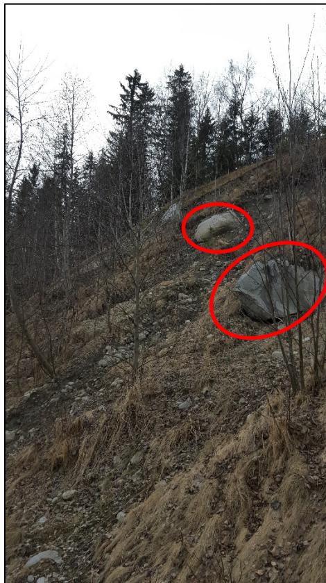
Figur 5. To andre blokker som har potensiale til å gjere skade. Blokka i Figur 2 – 4 er i bakgrunnen. I likskap med blokka i bakgrunnen er desse rekna til å ligge relativt stabilt no, men kan bli destabilisert ved utvasking av kringliggande lausmassar og undergraving i samband med ekstremnedbør og snøsmelting om våren. Det er dermed anbefalt å ta desse ned også.
