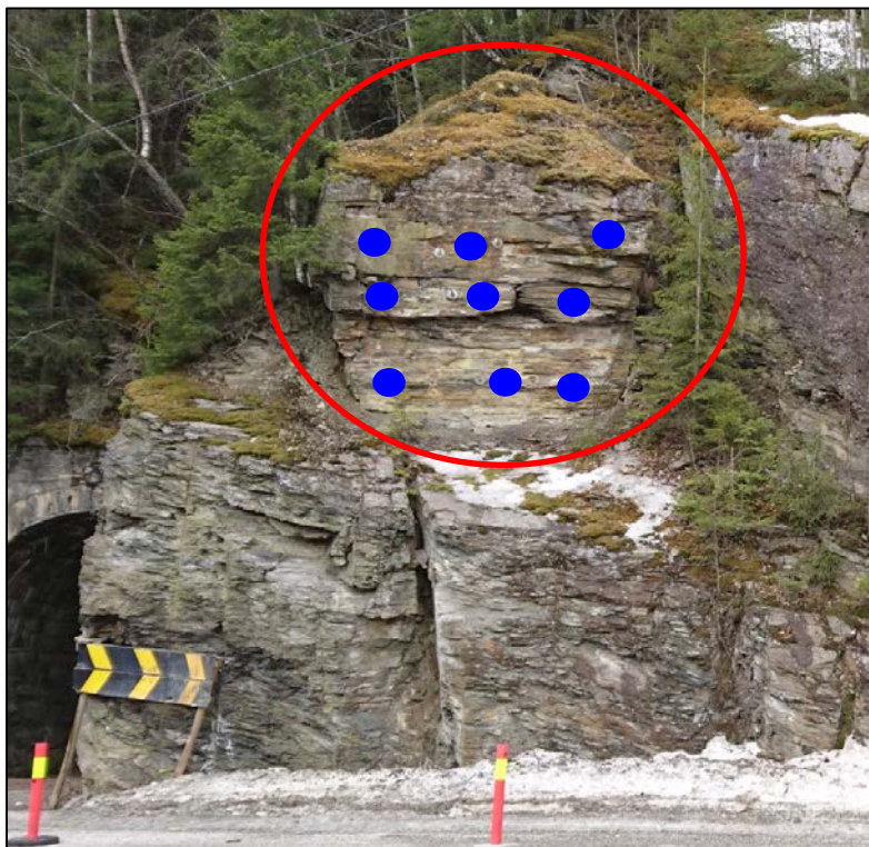
Figur 2. Blokka som det har vore uttrykt uro for i seinare tid, innanfor raud ellipse. Det er også teikna på forslag til cirka plassering av ni sikringsboltar dersom dette alternativet blir føretrakt, synt som blå rundingar. Originalfoto: Mizanur Rahaman, SVV.
