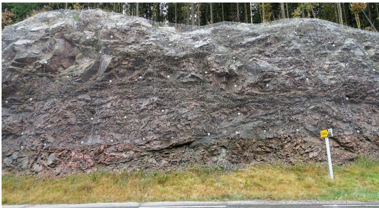
Figur 1 - Oversiktsbilde av meget oppsprukket berg mellom profil 5900-5950 (langs Repstadveien).
