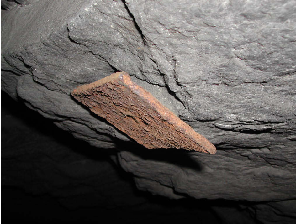
Figur 11 Lokaltet 24 ved km 8,197. Eksempel på bolteplate med klang, men med mye synlig rust. (Flere bolter, se Figur 5.)
