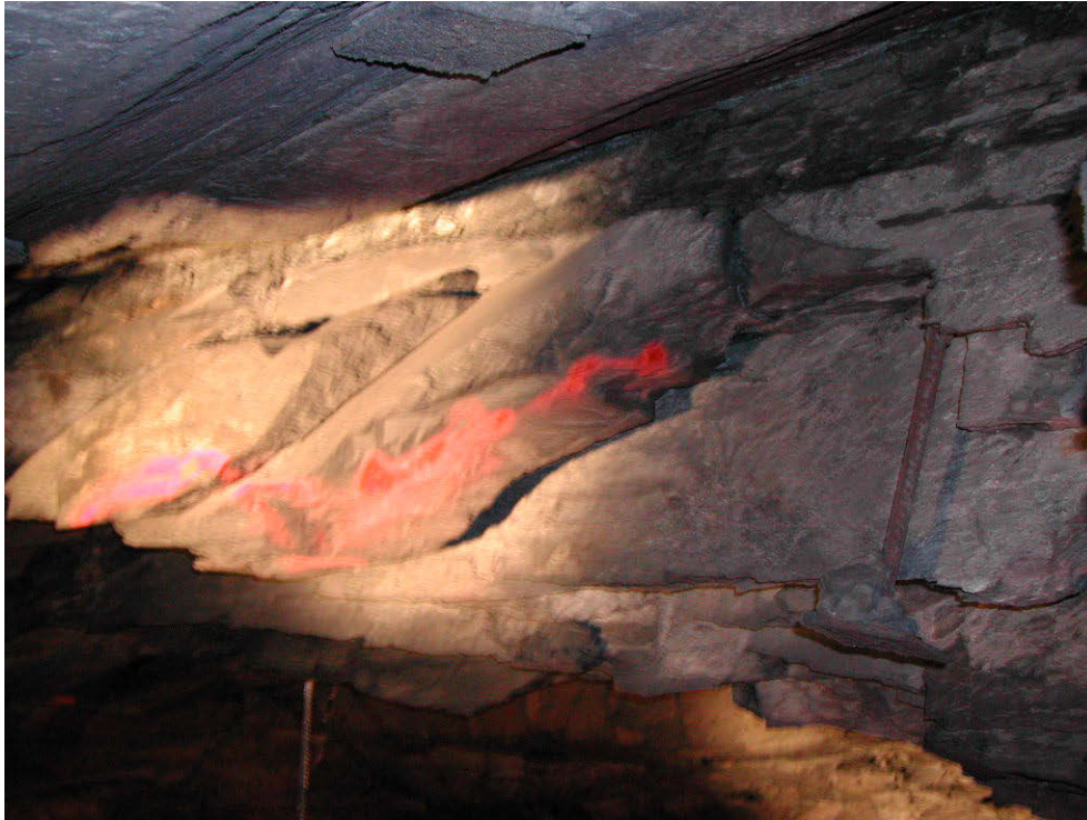
Figur 7 Lokaltet 16 ved km 5,740. Løs blokk i hengen.
