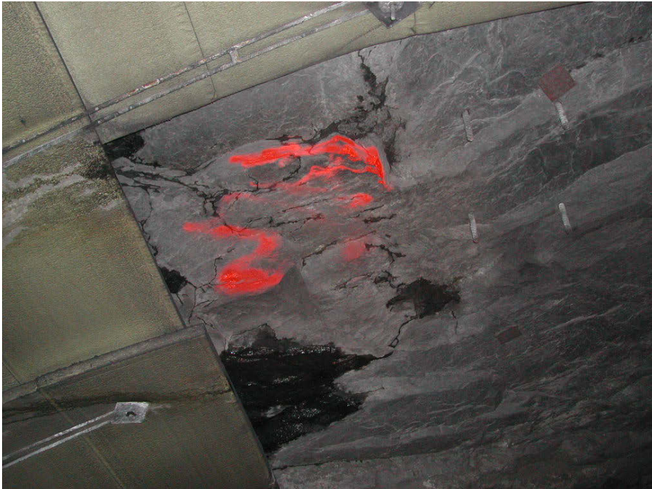
Figur 12 Lokaltet 26 ved km 8,419. Åpne sprekker, område markert for rensk, evt sikring.
