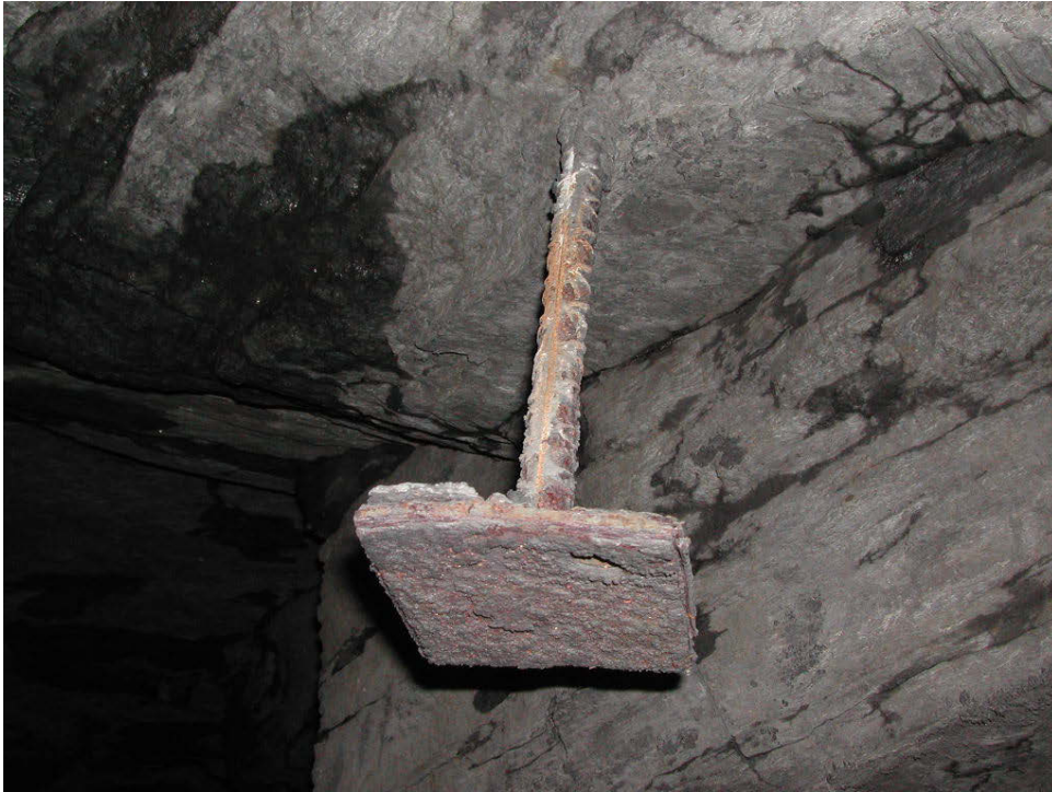
Figur 5 Lokalitet 13 ved km 5,452. Gjennomrustne bolteplater, usikkert hvor reduserte selve boltene er.
