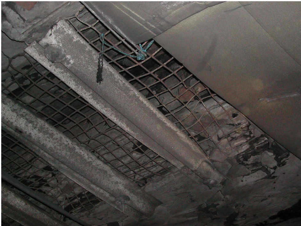
Figur 8 Lokaltet 17 ved km 5,781. Nett-sikret område som bør renskes og sprutes inn.
