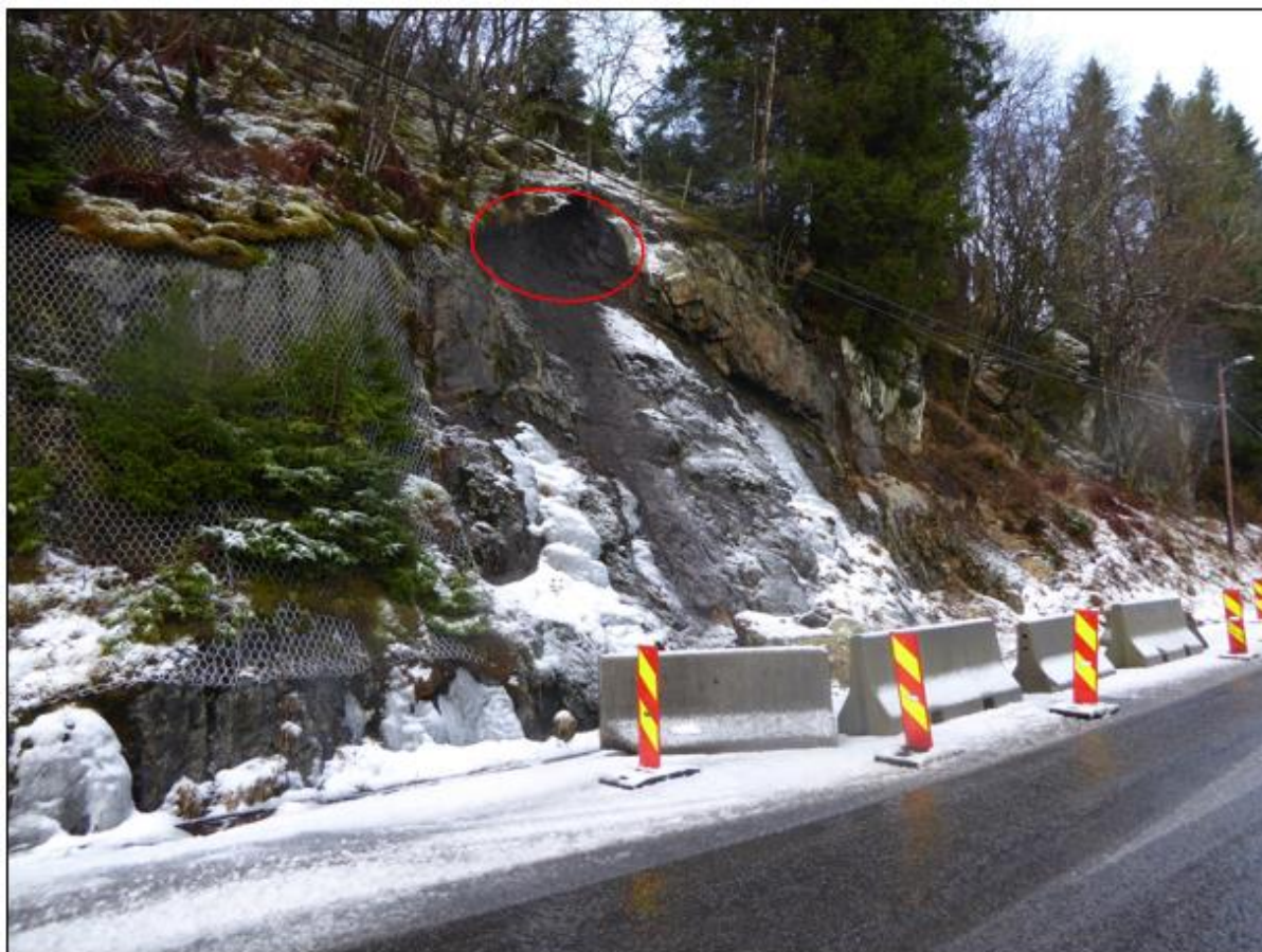
Figur 2: Steinblokken har løsnet øverst i fjellskjæring, sirkelen markerer løsnepunktet.
