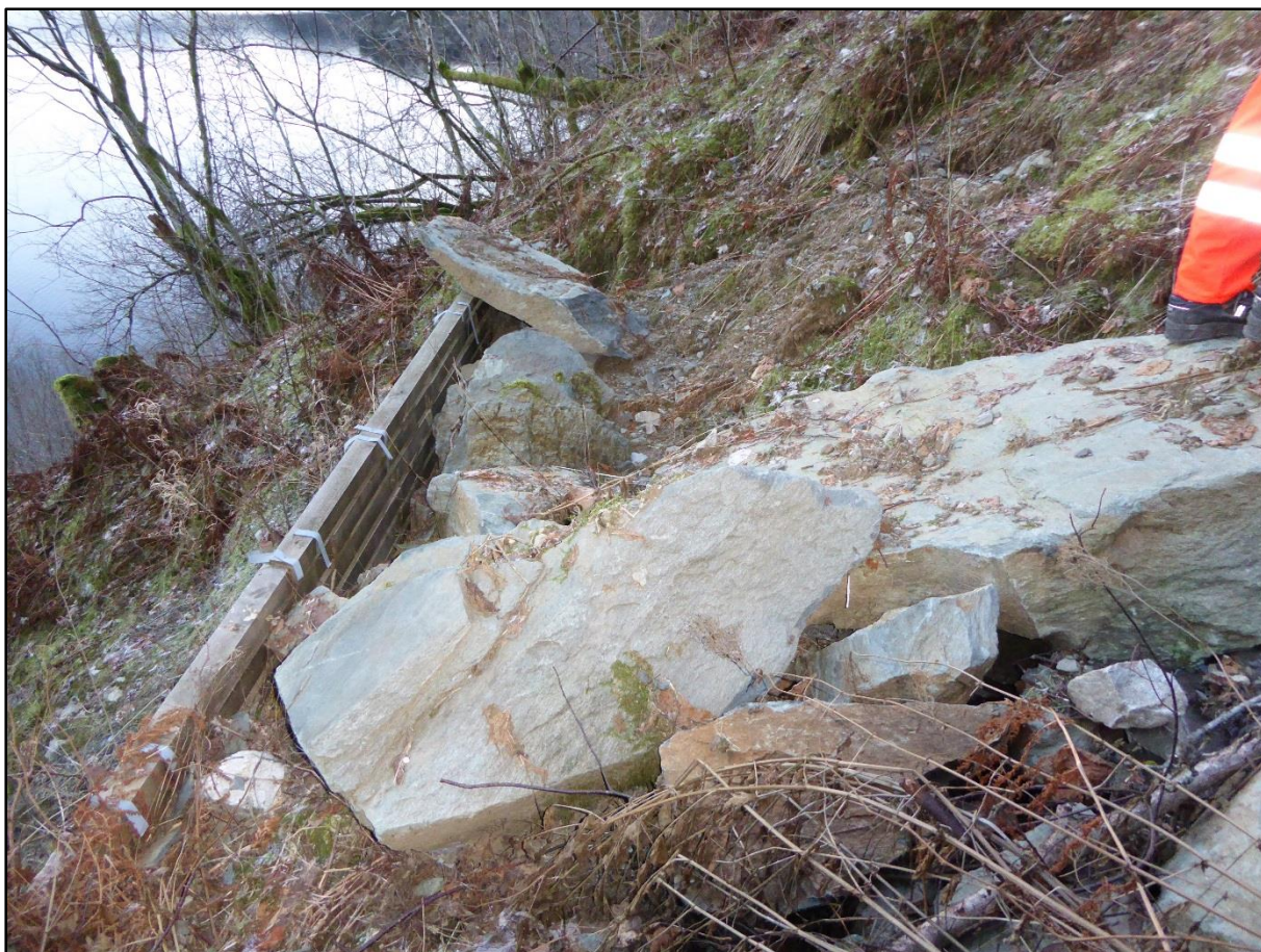
Figur 2: Sognemuren i nederste del av skredløpet er fylt med løsmasser og steinblokker, denne må renskes og kontrolleres for å opprettholde murens funksjon.
