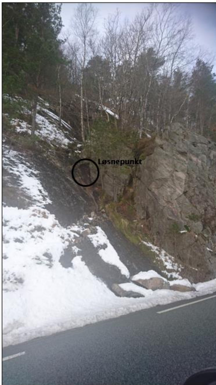
Figur 6: Steinblokkene løsnet i ytterkant av skjæring. Det er observert en del mindre steiner bak løsnepunktet, som kan komme ned i veggrøft.
