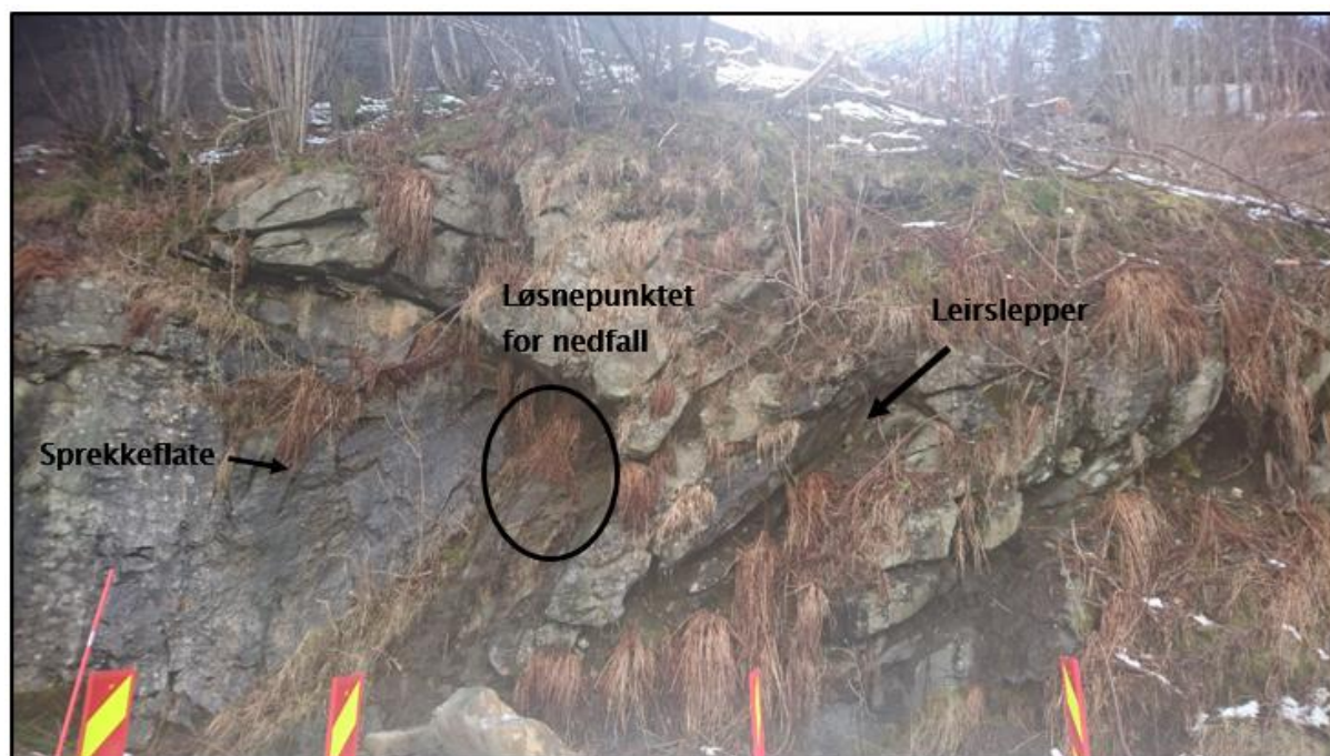
Figur 5: Skjæringen preges av svært forvitret og oppsprukket fjell, og er i dårlig forfatning. Flere åpne sprekker med leirfyll/leirslepper i skjæringen. Sprekkeflate parallelt skjæringen kan se ut til å gå bak det oppknuste partiet.
