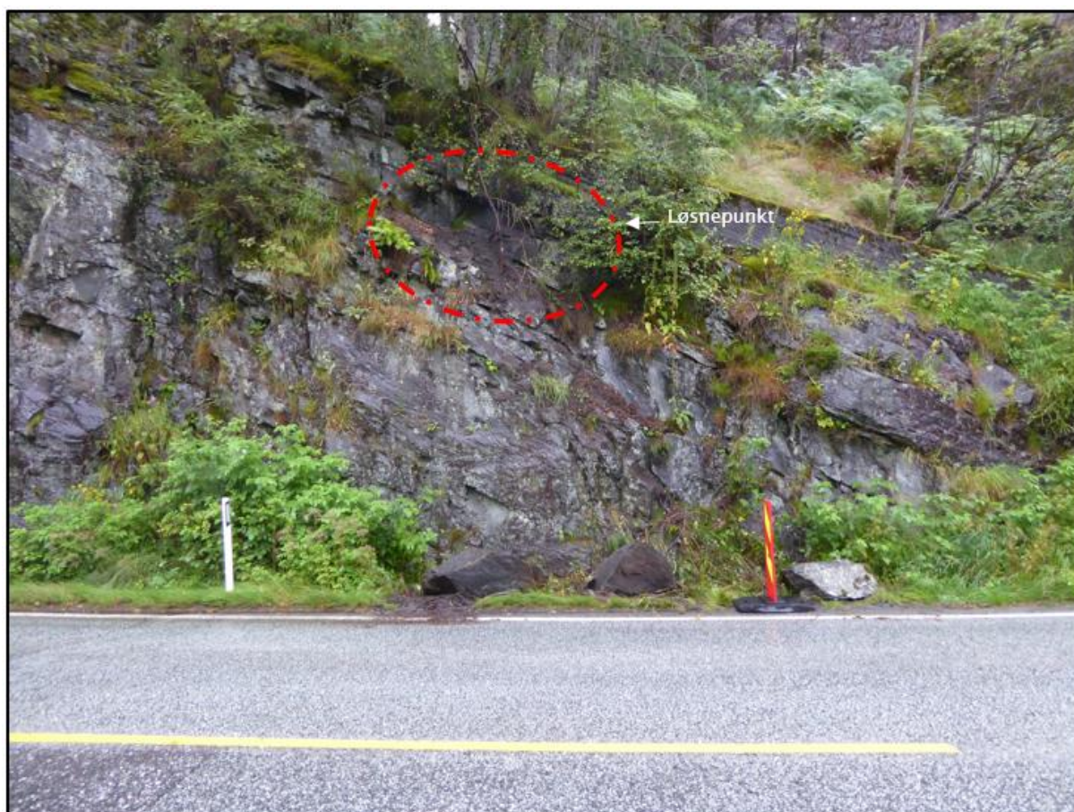
Figur 2: Steinblokkene løsnet fra ca. 2 m høyde i vegskjæring.
