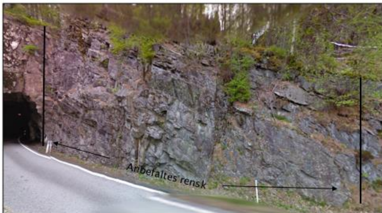
Figur 3: Det anbefales å utføre rensk i skjæringen frem til tunnelmunningen til Lille Urdalstunnel.
