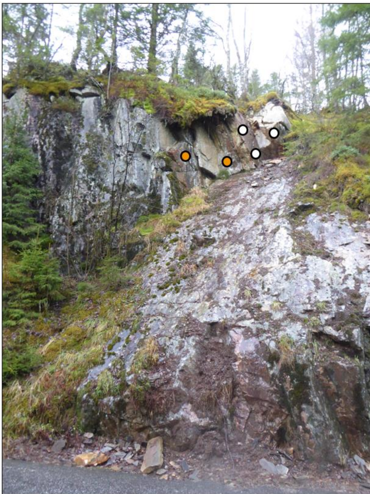
Figur 2: Bergskjæring ved hp 1 km 1,460. Det anbefales å sette 3 stk. 4 meter lange Ø20 mm bolter (hvit) og 2 stk. 3 meter lange Ø20 mm bolter (gul).
