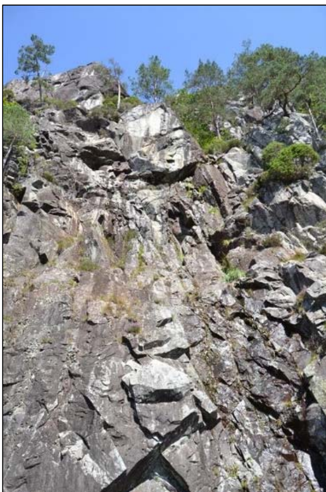
Bilde 8. Større blokkpartier med tvilsom stabilitet minst 30 m over vegen.
