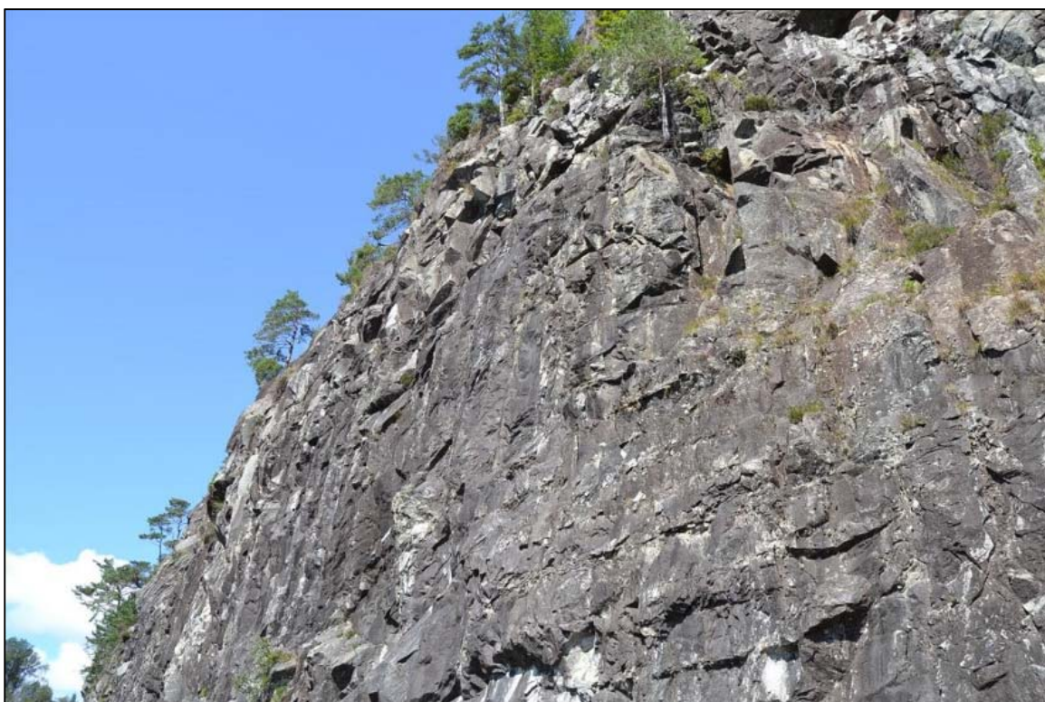
Bilde 10. Bergskjæringen og overliggende skrent er på deler av strekningen minst 30 m høy med mange synlig avløste blokker høyt oppe i skjæringen.
