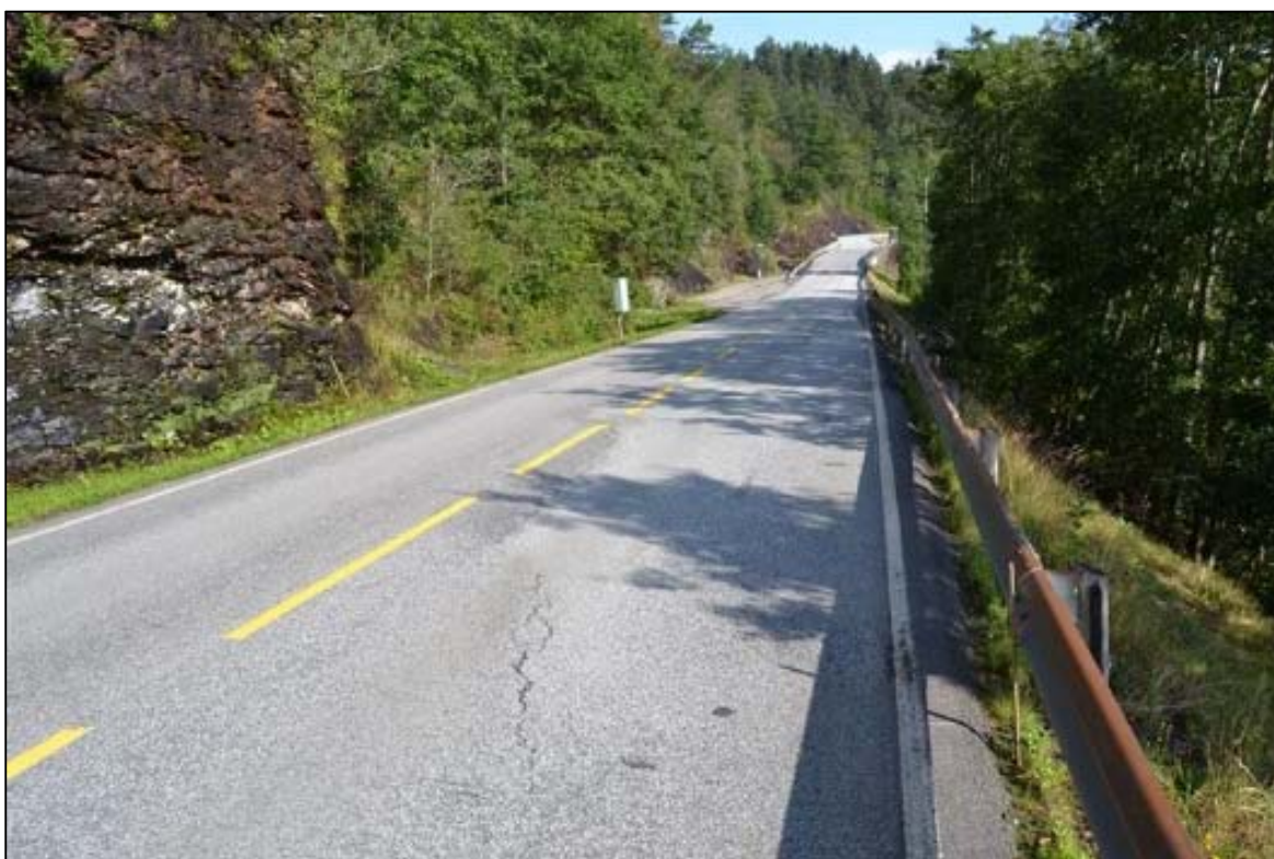
Bilde 2. Setningsskader på vegen ved borepunkt 2.
