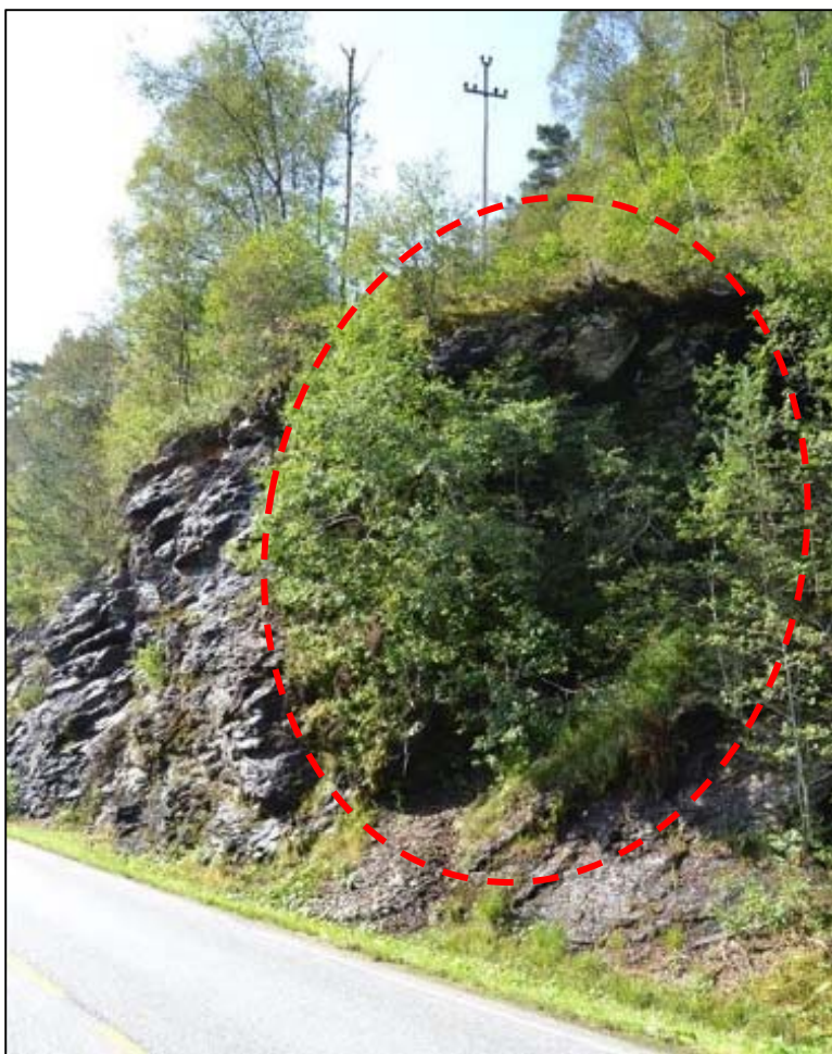
Bilde 7. Ustabil overhengende bergparti ved km20,8.
