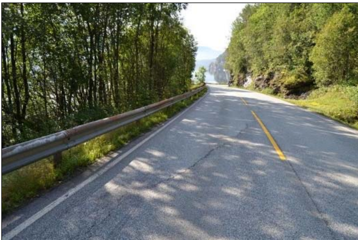
Bilde 3. Setningsskader på vegen ved ca. Hp1 km20,710. Sett mot sør.
