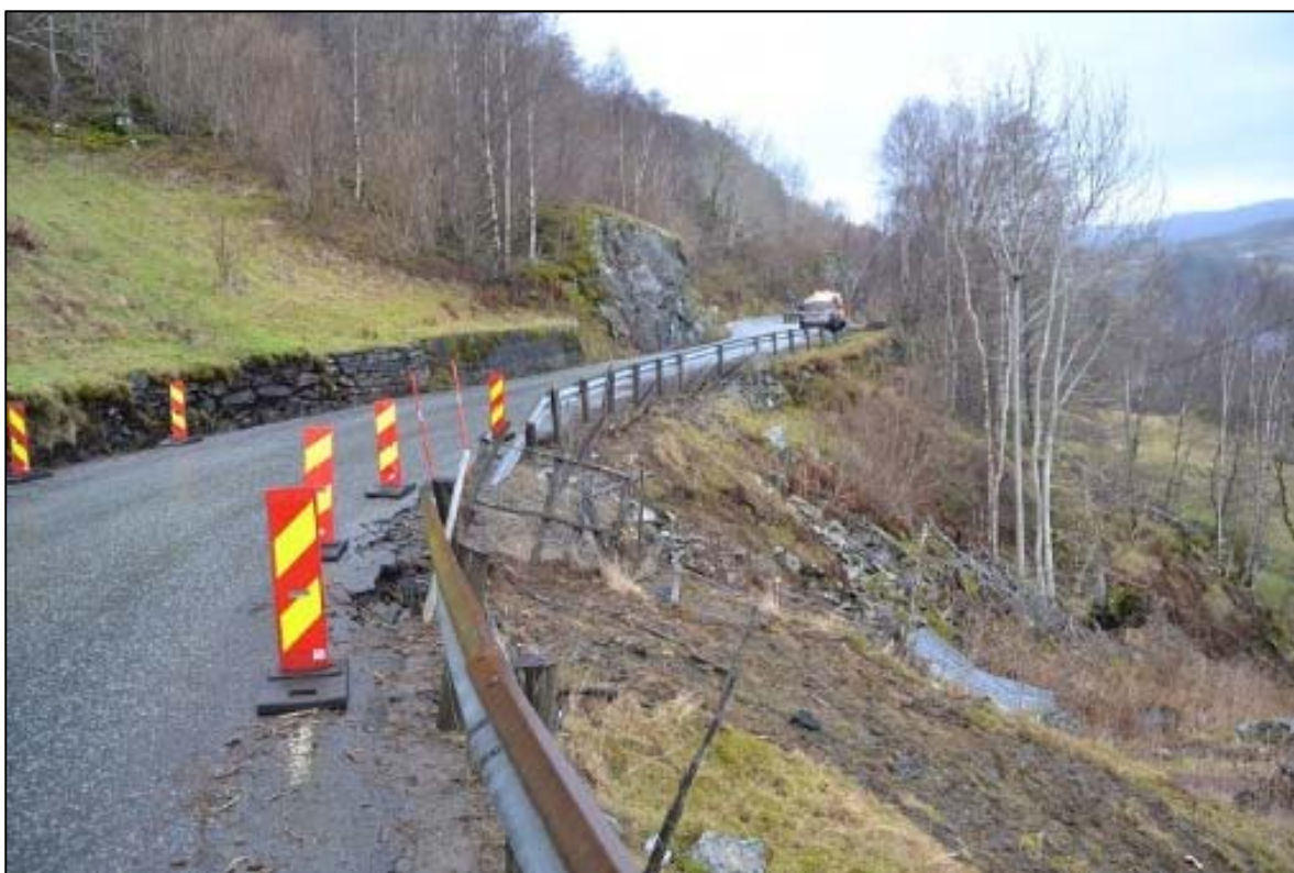
Bilde 5. Bærelaget og asfalten i nedre vegkant har kollapset etter flomskredet.
