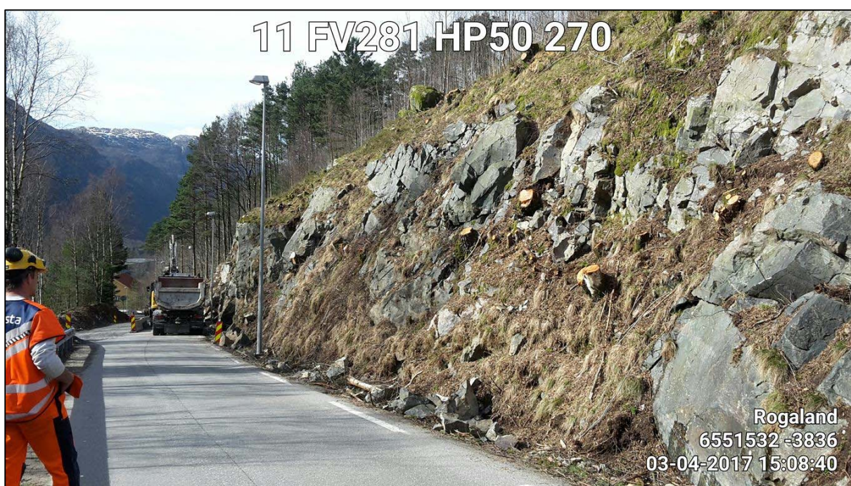
Bilde 4. Andre del av bergskjæringen som har mye jordmasser.
