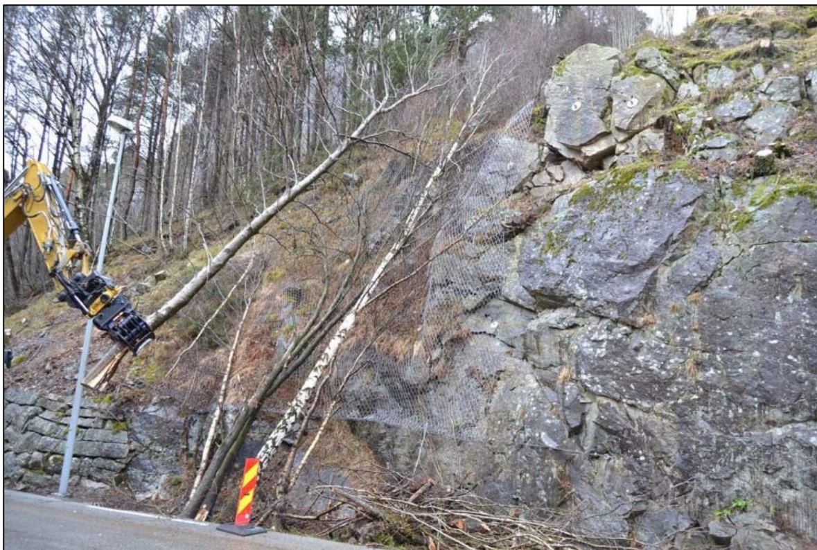
Bilde 1. Første delen av skjæringen er tidligere sikret med steinsprangnett og noen bolt.
