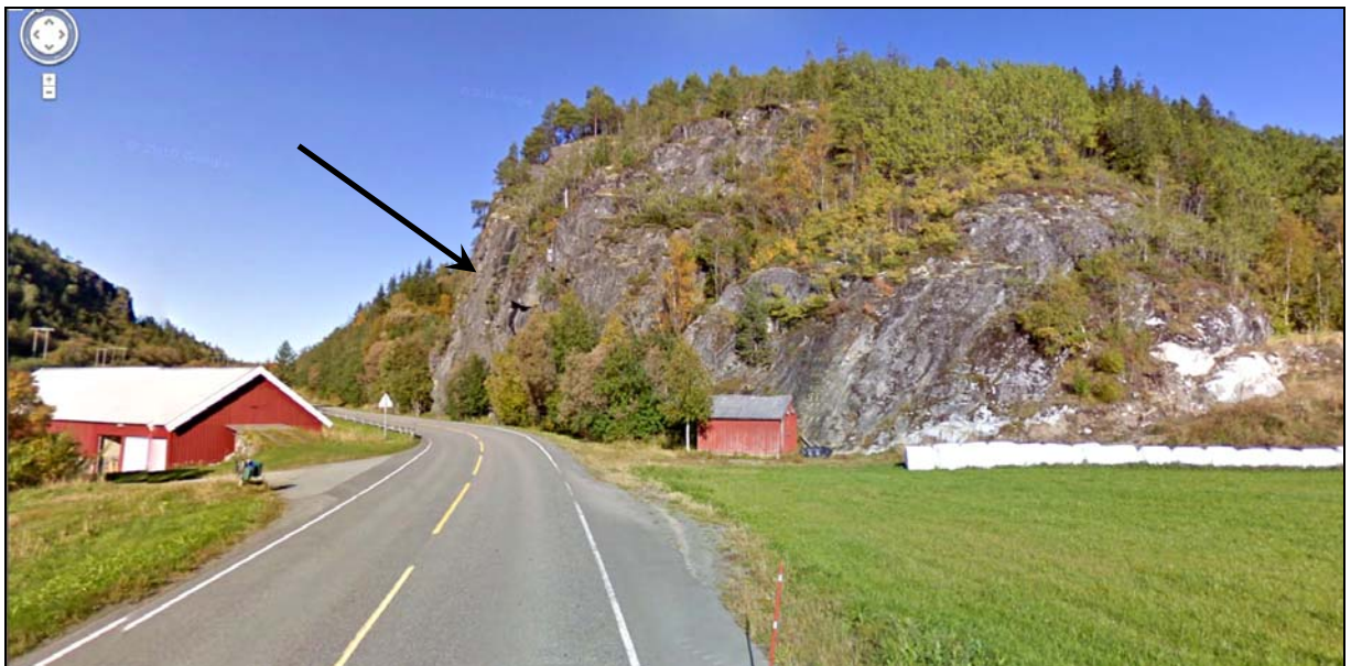
Figur 4: Foto av bergskjæringen i Arnvika sett mot nordøst. Løseområde er omtrent der pil peker. Kilde: GoogleMaps (ref 1),
