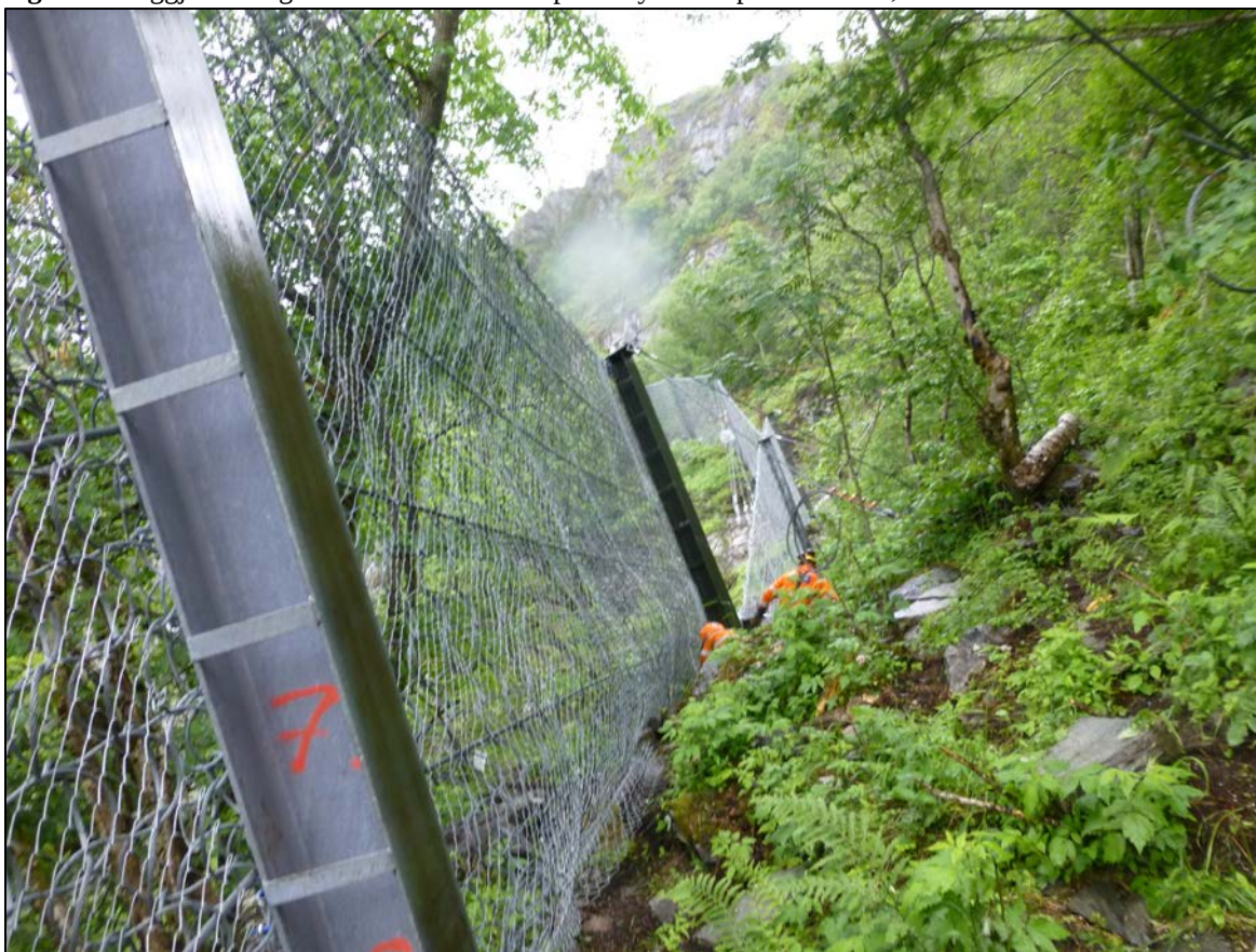
Figur 2. Fanggjærde TS-3000 sett mot Voss. En av to nye stolper sees nærmest fotografen. Videre mot Voss er det gjenbrukt stolper.
