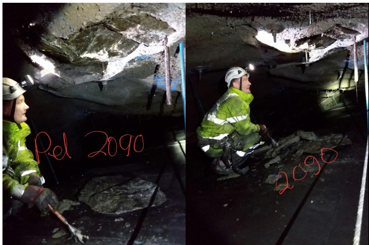
Figur 3: Nedfall av større sprøytebetongflak. Bilde til høyre er situasjonen før vi kakket ned ekstra betong, bilde til venstre er etter at det var tatt ned ekstra sprøytebetong. Berget er klink, men det er mer bom sprøytebetong i området.
