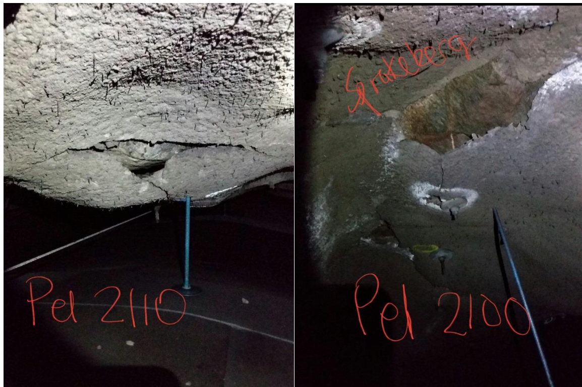
Figur 2: Oppsprukket sprøytebetong. Nedfall av betong.
