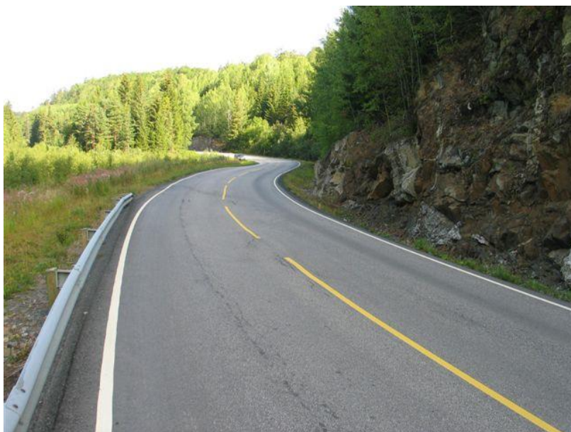
Bilde 1: Rv.38/Hp.05/Km.5,0 ved Bjordammyra (Foto: B. K. Dolva 10/8-2006).
