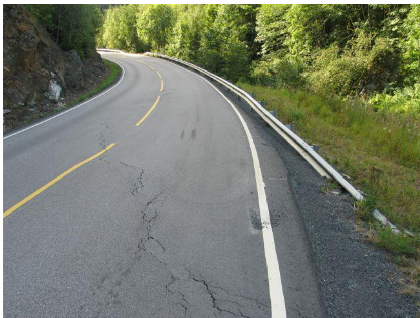
Bilde 2: Rv.38/Hp.05/Km.5,0 ved Bjordammyra (Foto: B. K. Dolva 10/8-06).
