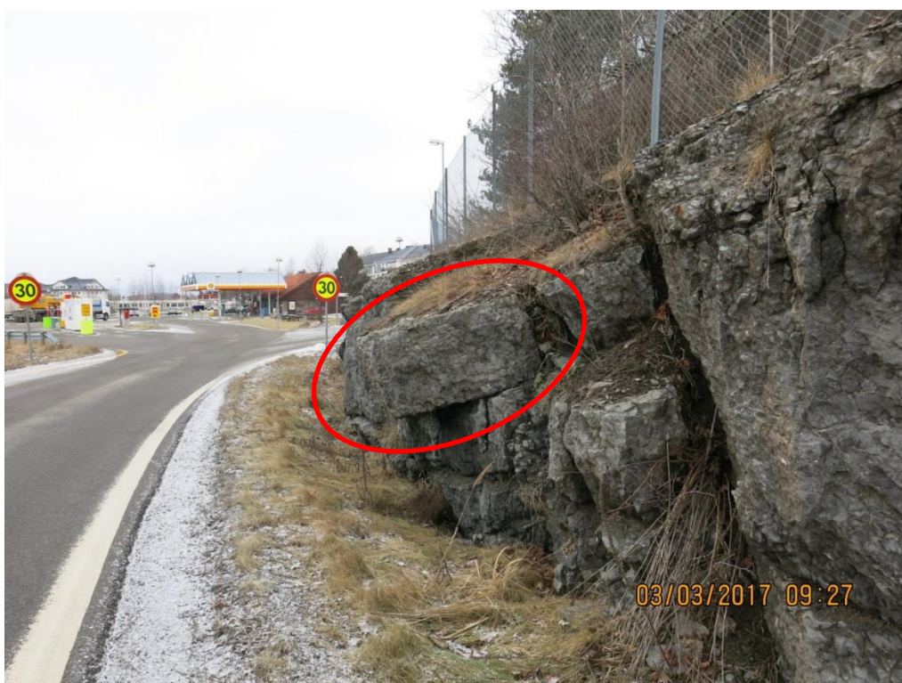
Bilde 8(over): I enden av bergskjæringa mot Shell stasjonen er det ei utstikkende bergblokk. Det anbefales at denne bergblokka fjernes.
