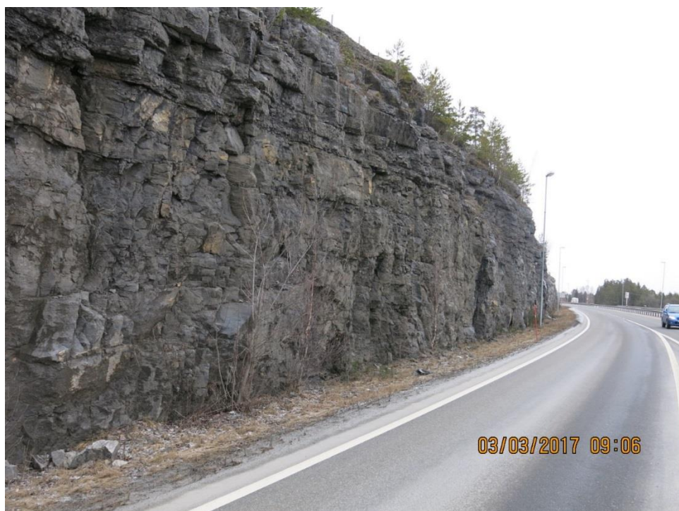
Bilde 3(over): Viser stedvis mye løst berg i skjæringa mellom m 6131 – 6247 Hp 53 ved avkjøring mot Shell stasjonen E16 ved Vik. Utføre vegetasjons rensk + spett rensk.
