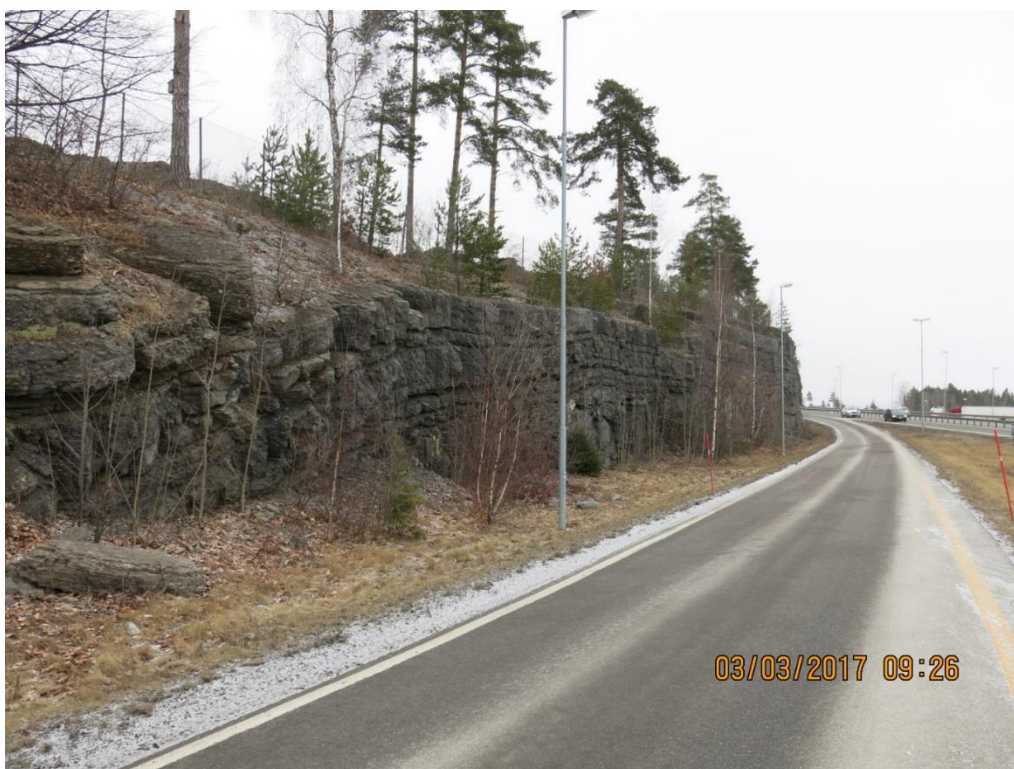
Bilde 6(over) Vegetasjons rensk i tilstøtende bergskjæring i avkjøringen til Shell stasjonen.
