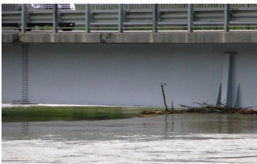
Figur 9. Bilde tatt kl 18:49. Brupilar 3 vises i bilden der vannstanden er oppstuet på grunn av kvister som har satt seg fast mellom brupilar og underkant bru. Kotehøyden underkant bru ved pilar tre er på 5,27. Foto: Statens vegvesen.
