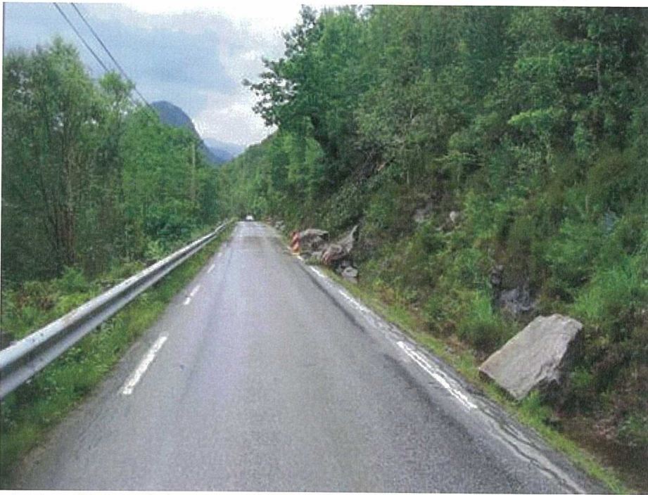
Figur 5. Vegen fikk bare mindre skader.
