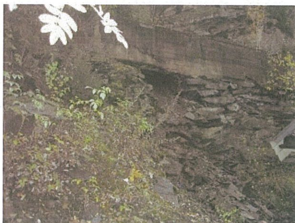
Utrasing av mur der rekkverk buler ut
