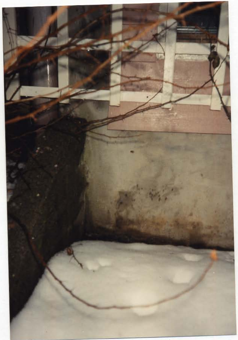
SPREKK I SOKKELMUR.
