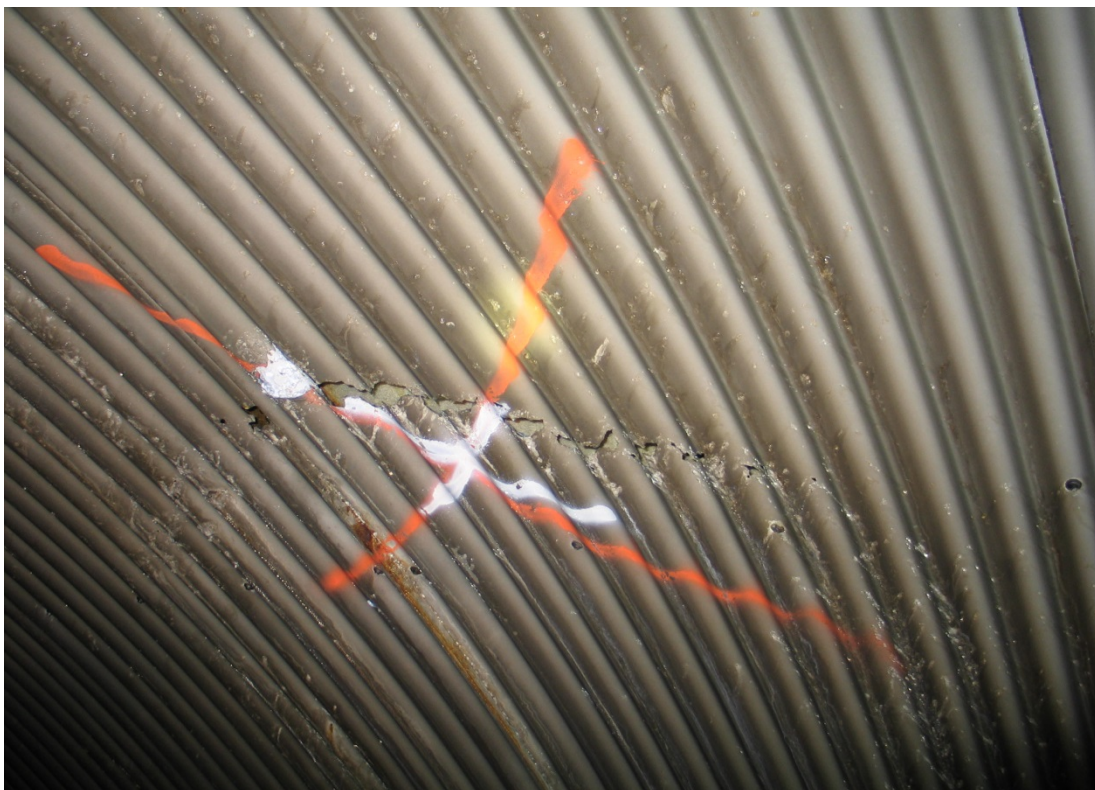
Bilde 3: Takplate har revnet som følge av korrosjon og montering for tett inn til bergoverflaten.
