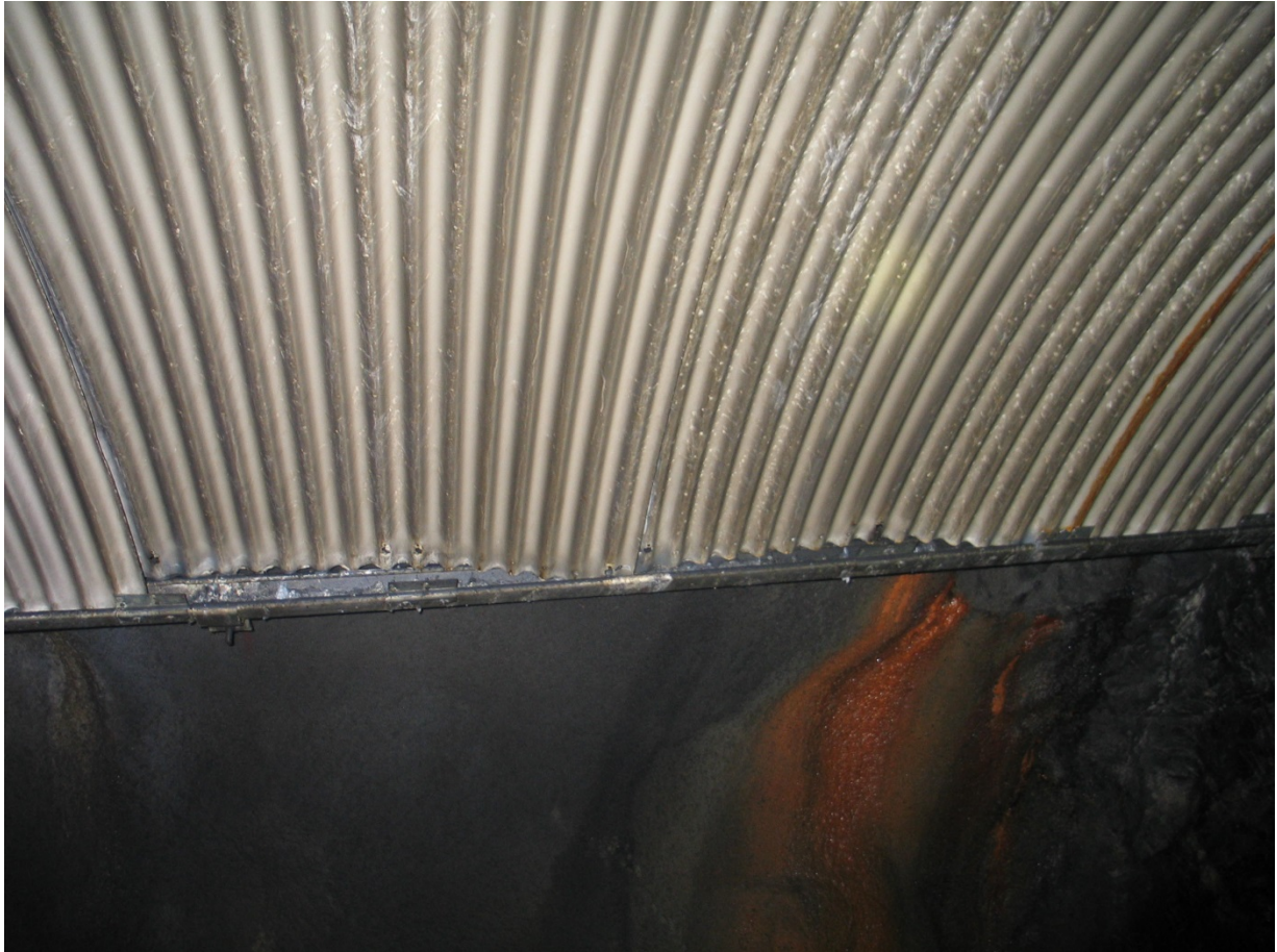
Bilde 5: Takplate revet løs fra takrenne.
