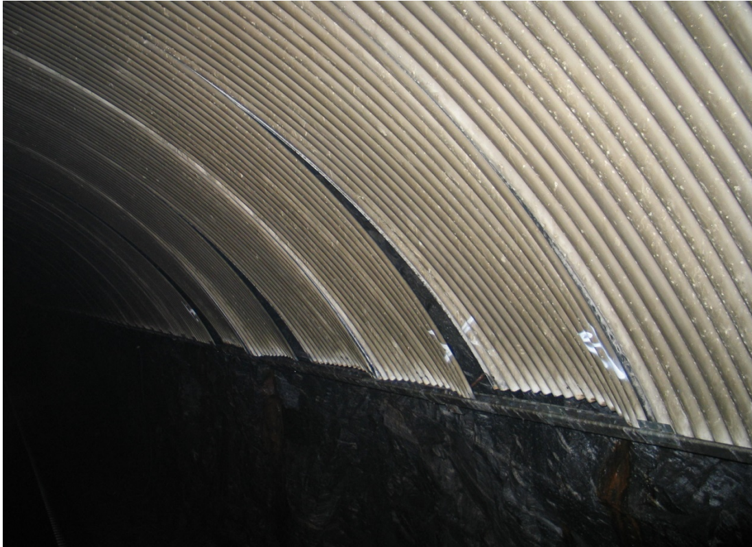
Bilde 2: Innfestingen til opphengssystemet svikter pga. korrosjon på takplatene.
