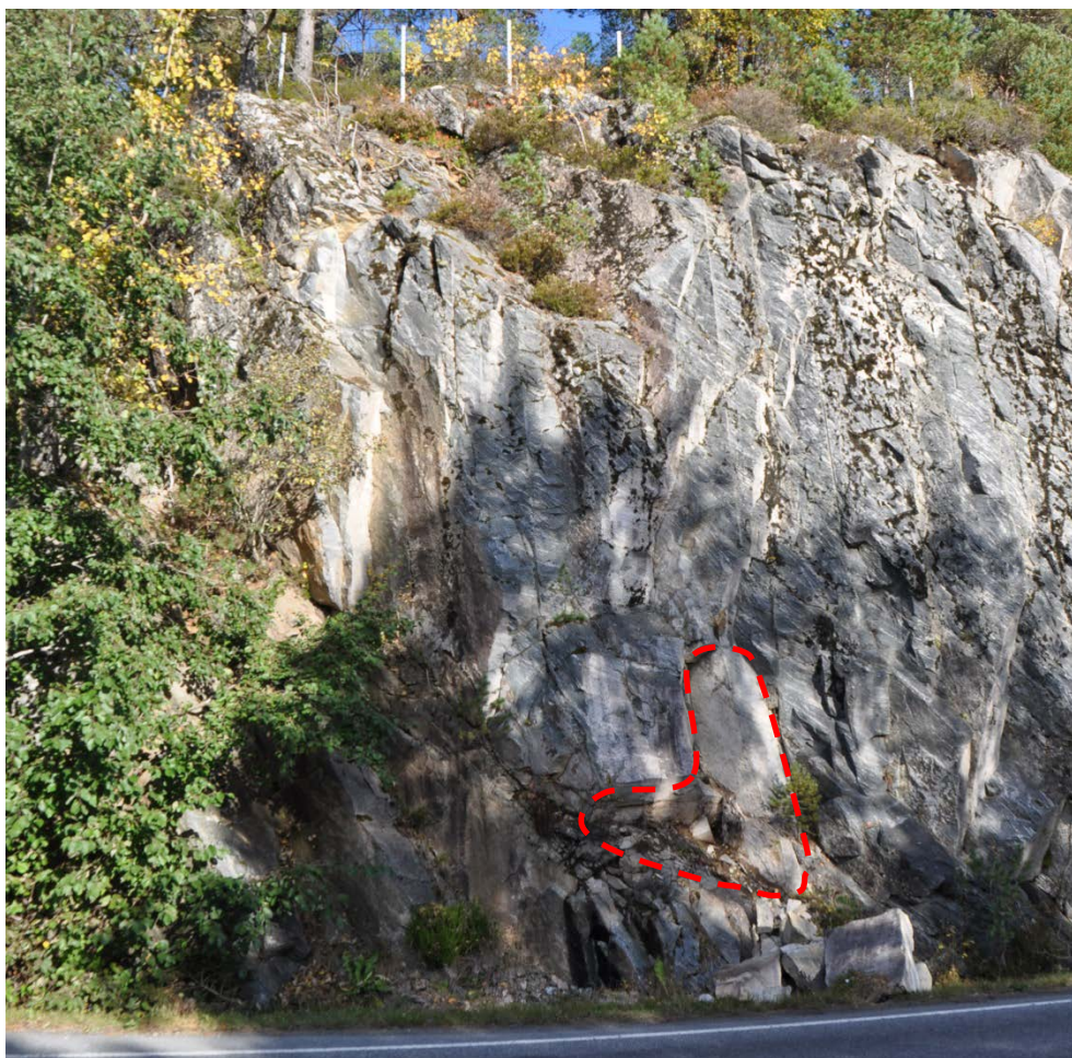
Figur 2. Vestre del av bergskjæringa. Løsneområdet for nedfallet er synlig ovenfor blokkene som ligger i grøfta.
