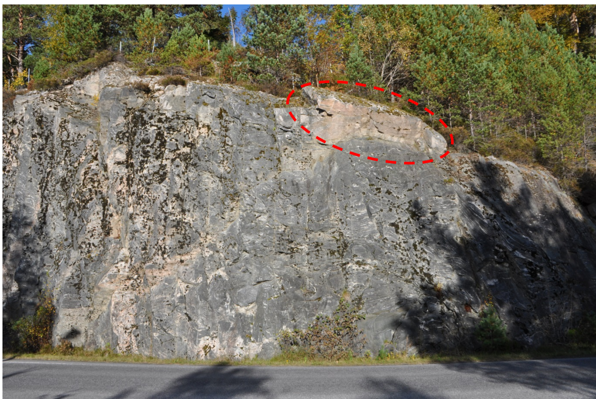
Figur 3. Østre del av bergskjæringa med mulig ustabil blokk på skjæringskant. Bør sikres med to bolter.
