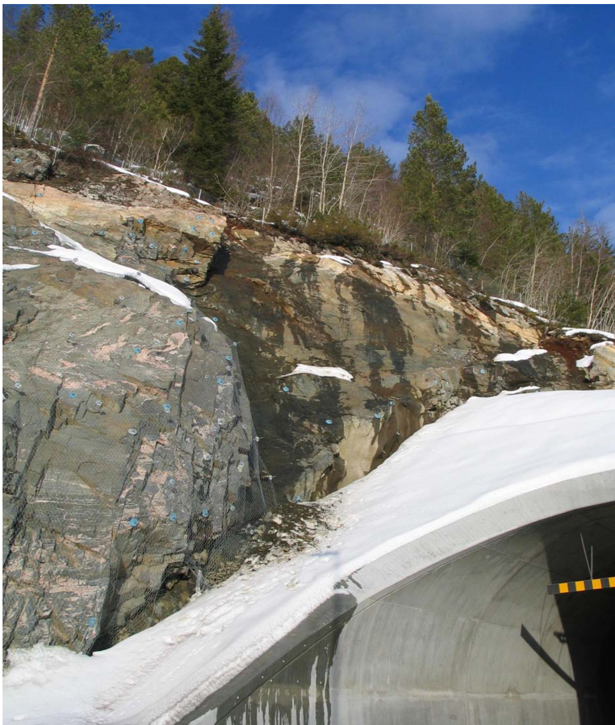
Bilde 3: Skjæringsveggen og nedraste masser ved vestre portal på Haukabøtunnelen.
