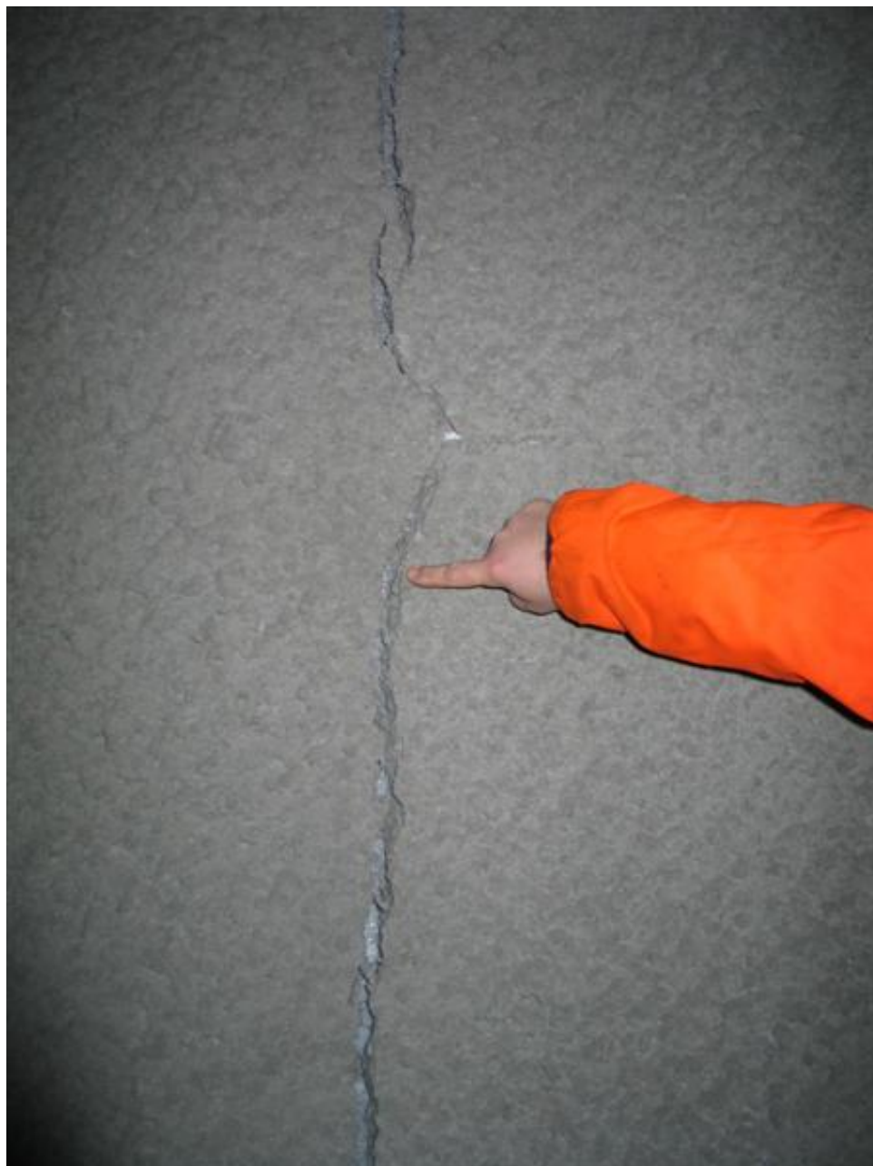
Bilde 2: Sprekk uten innlagt membran som "rissanviser".
