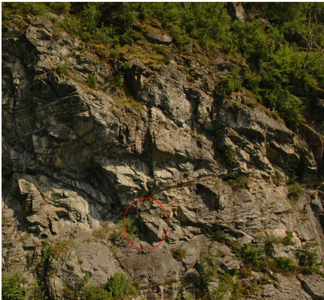
Figur 9: C6-4 er inspisert og vurdert, men ikke sprengt ned. Det kan bli aktuelt å ta ned denne i forbindelse med montering av fanggjerdet ettersom blokka kommer utenfor det nye gjerdet (foto: Multiconsult).
