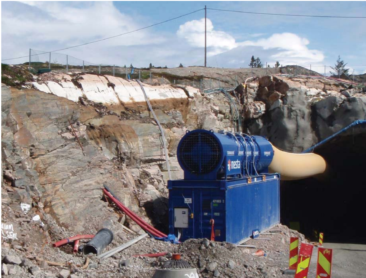
Figur 1: Venstre side avforskjæring inn mot påhugg. I dette området er det ikke utført sikring i form av boltesikring eller sprøytebetong.
