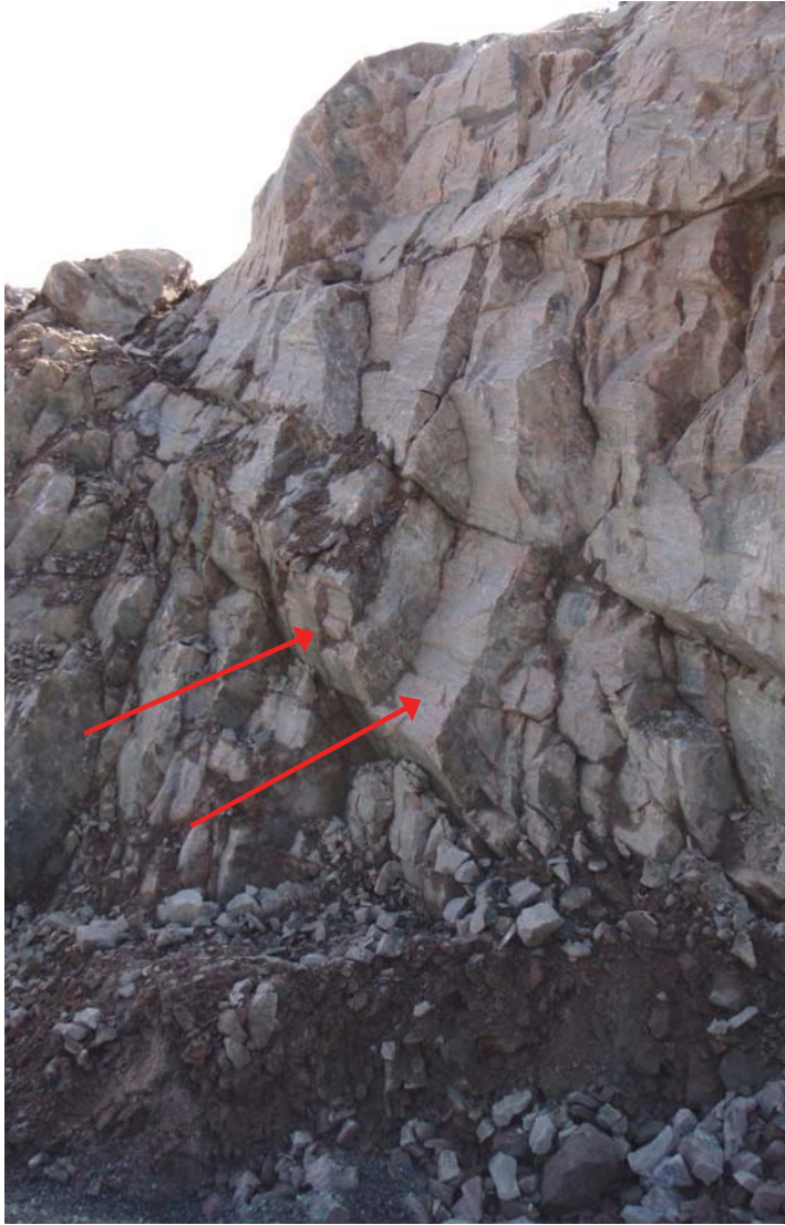
Figur 4: Delvis underkuttet parti. Pil viser blokker som bør vurderes å boltes fast.
