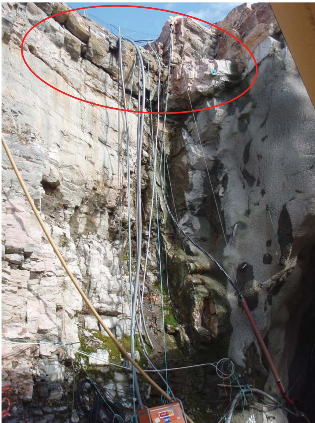
Figur 2: Venstre side av forskjæring inn mot påhugg. Ustabil parti i toppen av skjæring inn mot hjørnet er markert med rød ring.
