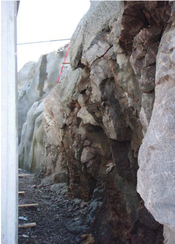
Figur 3: Oppsprukket bergmasse bak teknisk bygg på høyre side av forskjæring.
