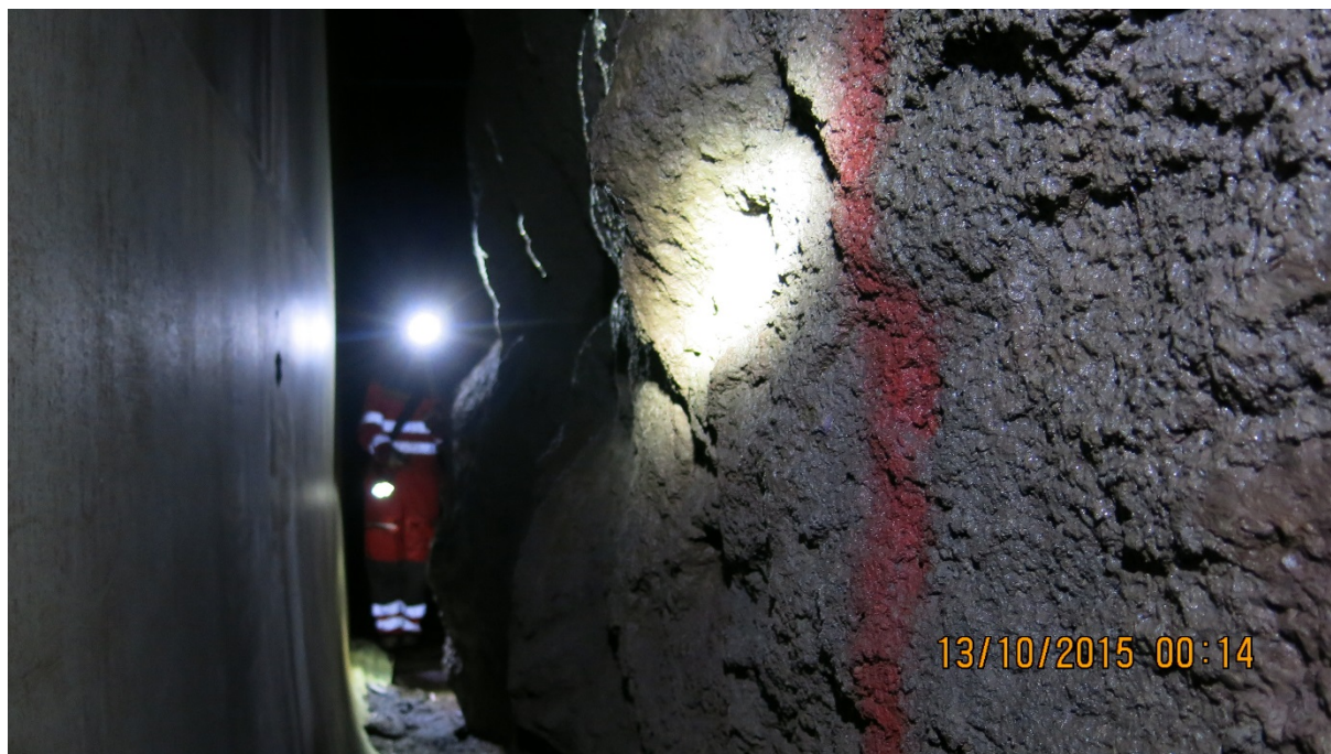
Figur 1: Fukt ved km. 3110
